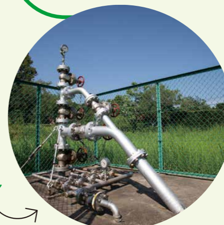
地層中の天然ガスを 地下水とともに汲み上げるガス井
